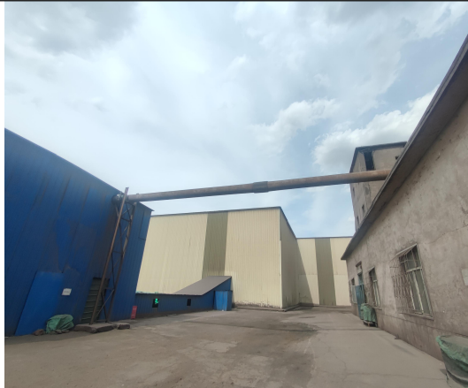
皮带运输+集气管道
