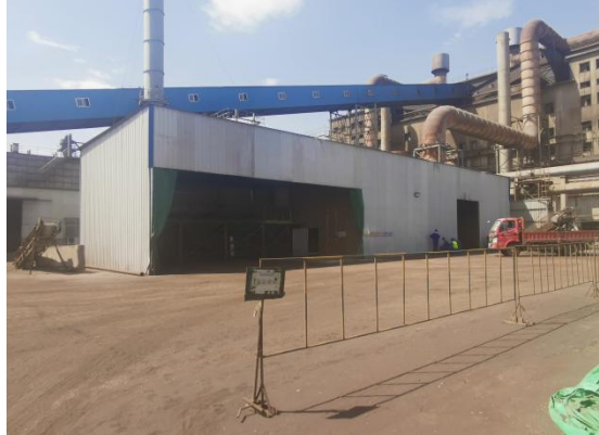
依托现有 8#矿热炉排气筒
